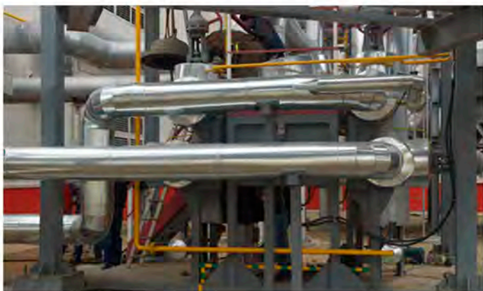
Эксплуатируется ООО «ЛУКОЙЛ - Кубаньэнерго», Заказчик ООО «ЛУКОЙЛ - Кубаньэнерго»
