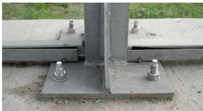
Применение анкер-шпилек из упрочненной стали при динамических воздействиях (крепление стоек шумозащитных экранов)
