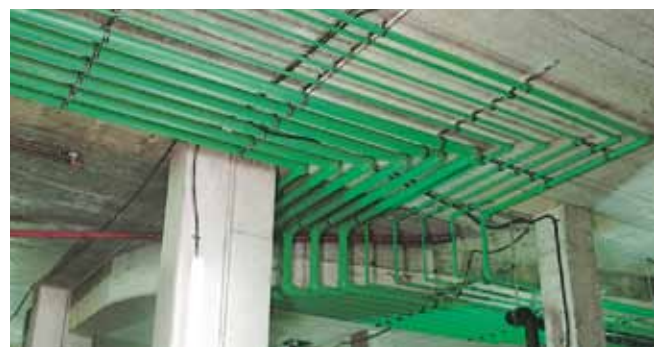
Трубопроводные линии для этажей
